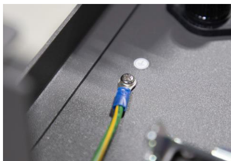
图 22：控制柜接地处
